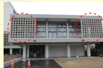
ブロック破損による倒壊の危険性がある松下会館
